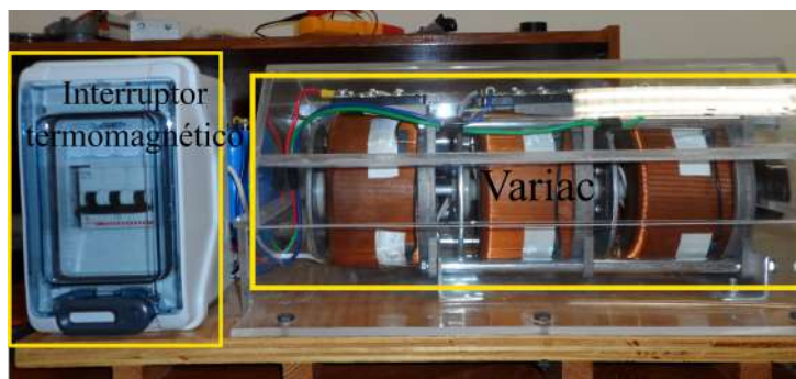
Figura 5.2: Autotransformador trifásico STACO ENERGY 1010B-3.
